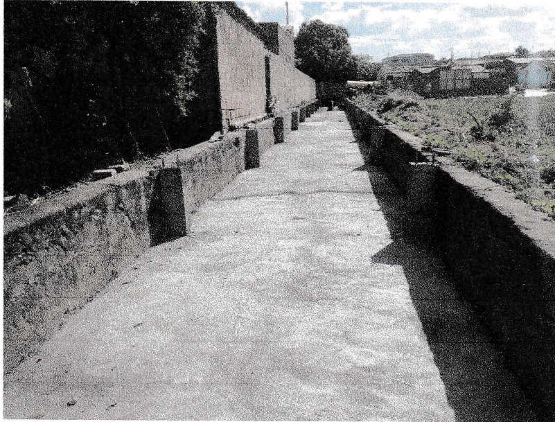
FIGURA 13 – EXECUÇÃO DE CONTRAPISO DO TRECHO ENTRE A RUA BEVENUTO ALVES DA ROCHA E A RUA VICENTE DAS CHAGAS DE OLIVEIRA;
