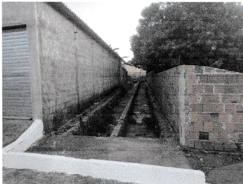
FIGURA 2 – EXECUÇÃO DOS SERVIÇOS DE ARMAÇÃO, EXECUÇÃO DE FORMAS E CONCRETAGEM DE PILARETES DO TRECHO ENTRE A RUA MARIA EVARISTO DE PAIVA E A RUA BEVENUTO ALVES DA ROCHA;
