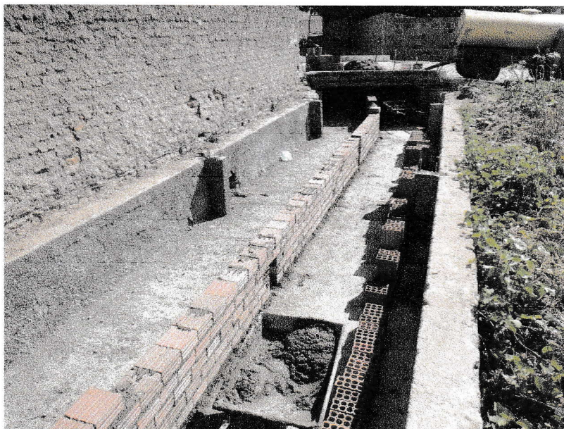
FIGURA 12 – EXECUÇÃO DOS SERVIÇOS DE CONCRETAGEM DE PILARETES ‘DO TRECHO ENTRE A RUA BEVENUTO ALVES DA ROCHA E A RUA VICENTE DAS CHAGAS DE OLIVEIRA;
