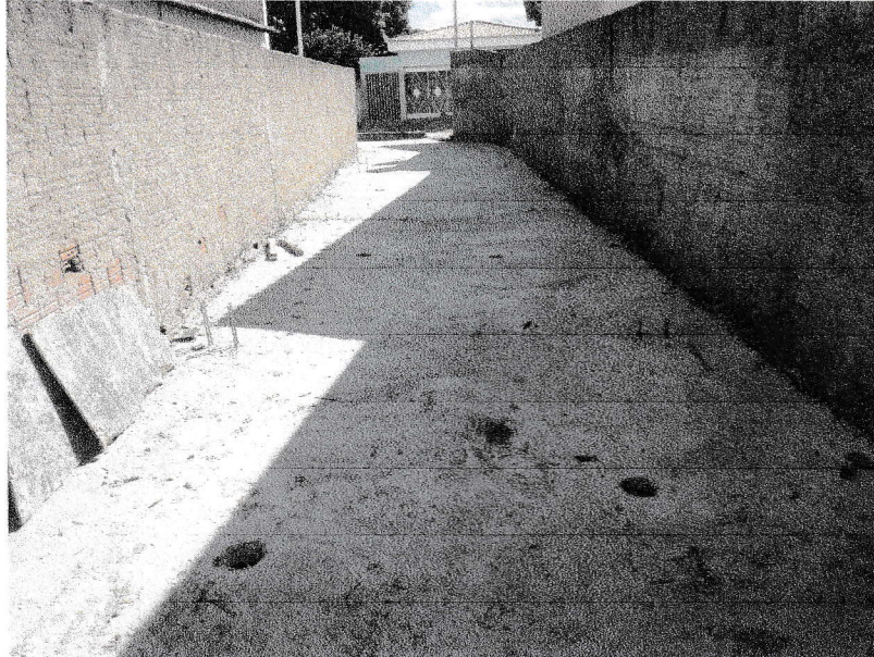
FIGURA 9 – EXECUÇÃO DE CONCRETAGEM DE LAJE E VIGAMENTOS DO TRECHO ENTRE A RUA DELFINO FRANCISCO E A RUA MARIA EVARISTO DE PAIVA;
