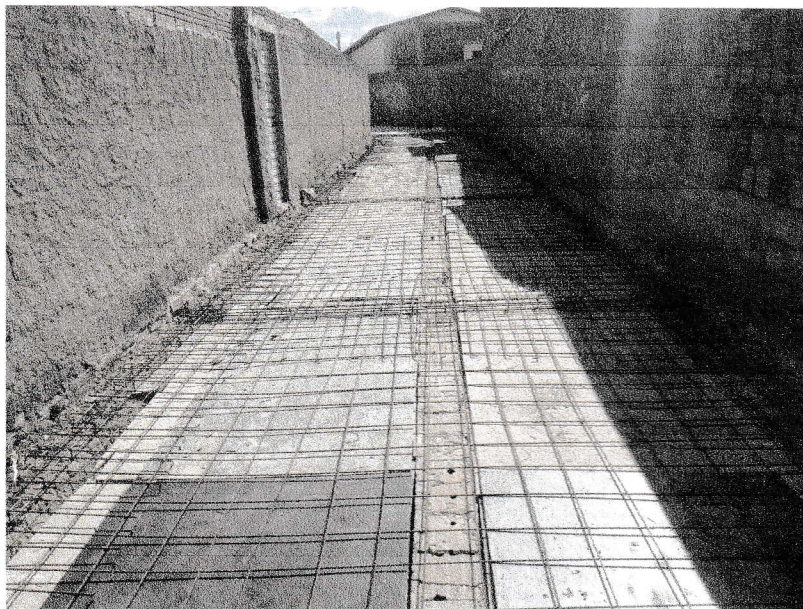
FIGURA 7 – EXECUÇÃO DE FORMAS E ARMAÇÃO DE LAJES E VIGAMENTOS DO TRECHO ENTRE A RUA DELFINO FRANCISCO E A RUA MARIA EVARISTO DE PAIVA;
