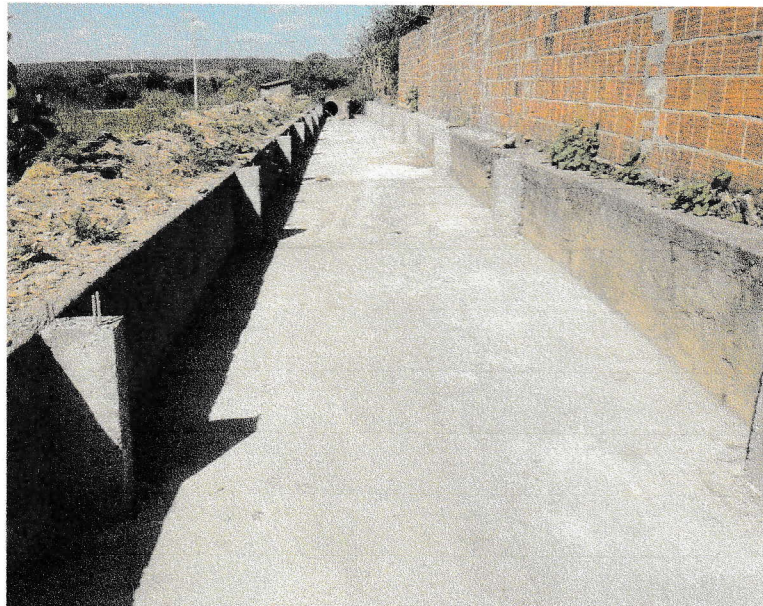
FIGURA 14 – EXECUÇÃO DE CONTRAPISO DO TRECHO ENTRE A RUA BEVENUTO ALVES DA ROCHA E A RUA VICENTE DAS CHAGAS DE OLIVEIRA;
