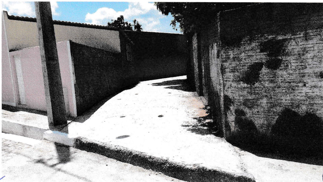
FIGURA 12 – SERVIÇO DE LIMPEZA FINAL DA OBRA - TRECHO ENTRE A RUA 07 DE SETEMBRO E A RUA DELFINO FRANCISCO;
