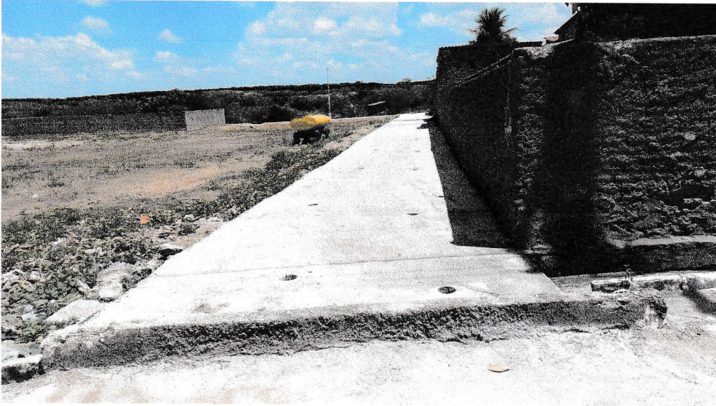
FIGURA 15 – SERVIÇO DE LIMPEZA FINAL DA OBRA - TRECHO ENTRE A RUA BEVENUTO ALVES DA ROCHA E A RUA VICENTE DAS CHAGAS DE OLIVEIRA;
