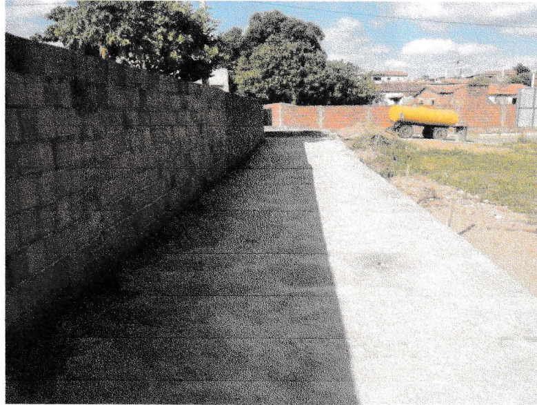
FIGURA 5 – EXECUÇÃO DE CONCRETAGEM DE LAJE E VIGAMENTOS DO TRECHO ENTRE A RUA BEVENUTO ALVES DA ROCHA E A RUA VICENTE DAS CHAGAS DE OLIVEIRA;
