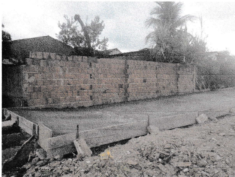
FIGURA 3 – EXECUÇÃO DE FORMAS E ARMAÇÃO DE LAJES E VIGAMENTOS DO TRECHO ENTRE A RUA BEVENUTO ALVES DA ROCHA E A RUA VICENTE DAS CHAGAS DE OLIVEIRA
