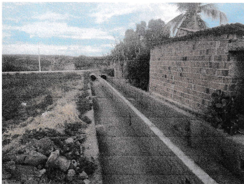
FIGURA 8 - EXECUÇÃO DE ALVENARIA DE TIJOLOS CERAMICOS, CHAPISCO E REBOCO DO TRECHO ENTRE A RUA BEVENUTO ALVES DA ROCHA E A RUA VICENTE DAS CHAGAS DE OLIVEIRA;
