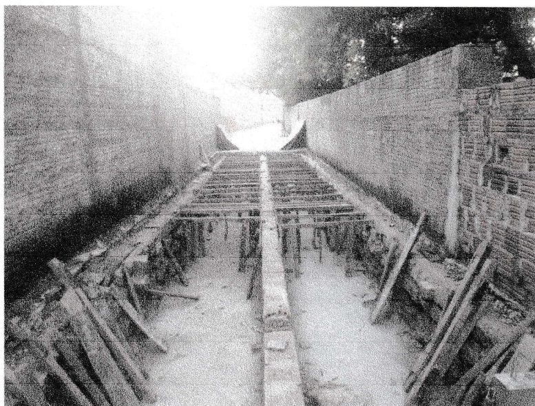
FIGURA 2 – EXECUÇÃO DE FORMAS DE LAJES E VIGAMENTOS DO TRECHO ENTRE A RUA MARIA EVARISTO DE PAIVA E A RUA BEVENUTO ALVES DA ROCHA;
