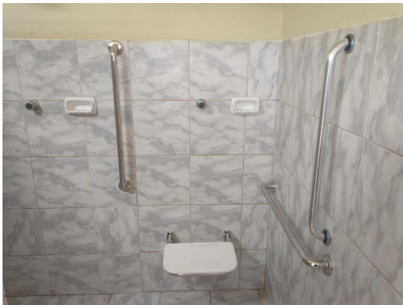
Figura 7 – EXECUÇÃO DE SERVIÇOS DE FIXAÇÃO DE BARRAS DE APOIO E ACESSIBILIDADE E SUBSTITUIÇÃO DE LOUÇAS SANITÁRIAS;
