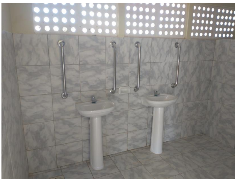
Figura 8 – EXECUÇÃO DE SERVIÇOS DE FIXAÇÃO DE BARRAS DE APOIO E ACESSIBILIDADE E SUBSTITUIÇÃO DE LOUÇAS SANITÁRIAS;
