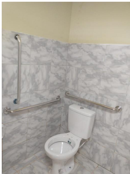
Figura 5 – EXECUÇÃO DE SERVIÇOS DE FIXAÇÃO DE BARRAS DE APOIO E ACESSIBILIDADE E SUBSTITUIÇÃO DE LOUÇAS SANITÁRIAS;
