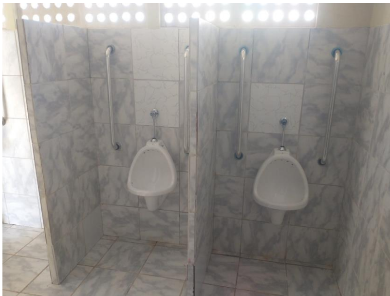
Figura 9 – EXECUÇÃO DE SERVIÇOS DE FIXAÇÃO DE BARRAS DE APOIO E ACESSIBILIDADE E SUBSTITUIÇÃO DE LOUÇAS SANITÁRIAS;
