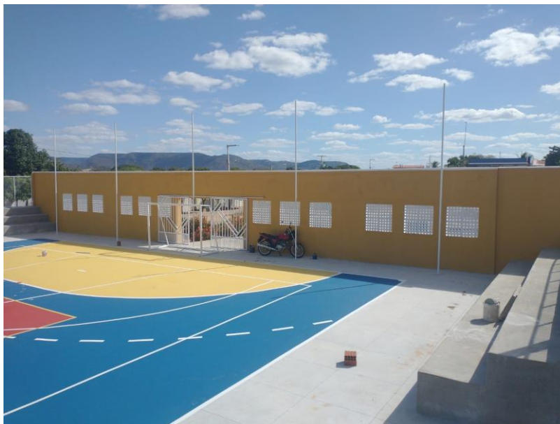
Figura 15 – EXECUÇÃO DE SERVIÇOS PINTURA DAS ÁREAS EXTERNAS, MARCAÇÃO E PINTURA DA QUADRA POLIESPORTIVA;
