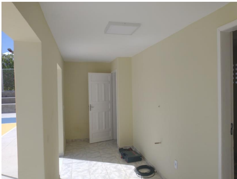
Figura 11 – EXECUÇÃO DE SERVIÇOS DE PINTURA E INSTALAÇÕES DE LUMINÁRIAS, TOMADAS E INTERRUPTORES;
