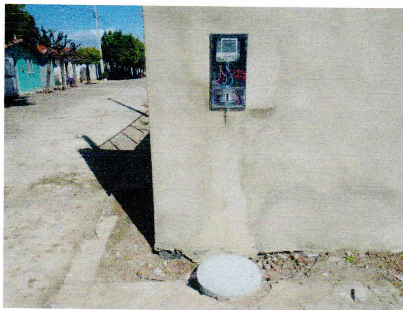
Figura 14 - PADRÃO DE ENTRADA DE ENERGIA (FINALIZADO);
