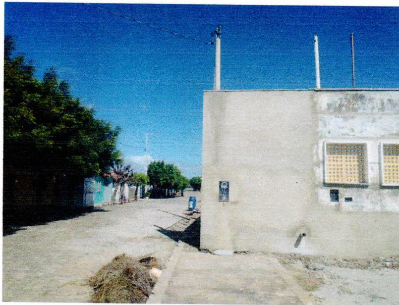
Figura 15 – PADRÃO DE ENTRADA DE ENERGIA (FINALIZADO);
