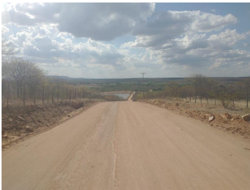
FIGURA 16 – EXECUÇÃO DE SERVIÇOS DE COMPACTAÇÃO DE MATERIAL COM ROLO COMPACTADOR – TRECHO NA COMUNIDADE BAIXA DO ARROZ;
