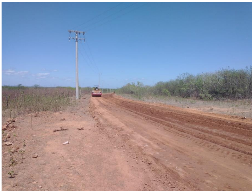
FIGURA 26 – EXECUÇÃO DE ESTRADAS VICINAIS NO MUNICÍPIO DE RIACHO DA CRUZ – RN - TRECHO NA COMUNIDADE BAIXA DO ARROZ;
