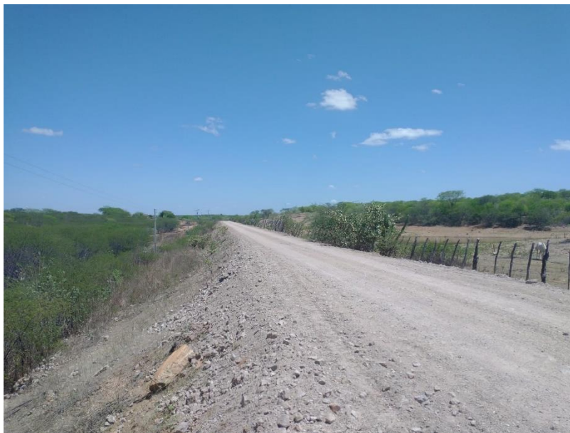
FIGURA 23 – EXECUÇÃO DE ESTRADAS VICINAIS NO MUNICÍPIO DE RIACHO DA CRUZ – RN - TRECHO NA COMUNIDADE BAIXA DO ARROZ;
