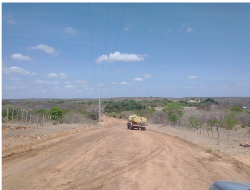
FIGURA 12 – EXECUÇÃO DE SERVIÇOS DE ESPALHAMENTO DE MATERIAL COM MOTONIVELADORA – TRECHO NA COMUNIDADE BAIXA DO ARROZ;
