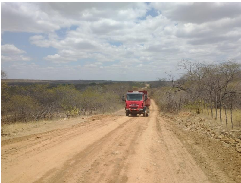
FIGURA 5 – EXECUÇÃO DE ESTRADAS VICINAIS NO MUNICÍPIO DE RIACHO DA CRUZ – RN - TRECHO NA COMUNIDADE BAIXA DO ARROZ;
