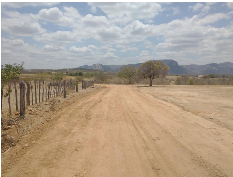
FIGURA 6 – EXECUÇÃO DE ESTRADAS VICINAIS NO MUNICÍPIO DE RIACHO DA CRUZ – RN - TRECHO NA COMUNIDADE BAIXA DO ARROZ;
