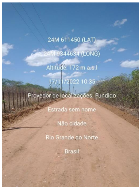
FIGURA 31 – EXECUÇÃO DE ESTRADAS VICINAIS NO MUNICÍPIO DE RIACHO DA CRUZ – RN - TRECHO NA COMUNIDADE BAIXA DO ARROZ;
