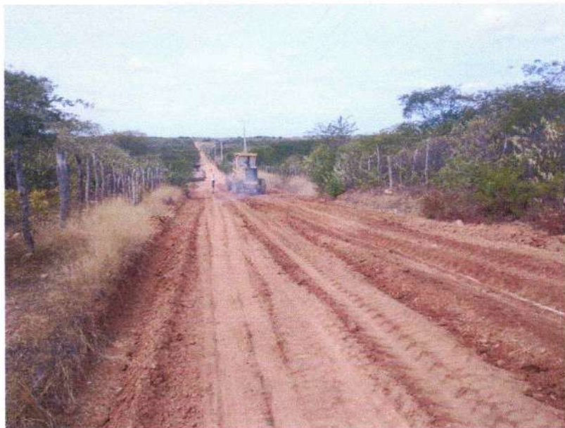
FIGURA 11 – EXECUÇÃO DE SERVIÇOS DE ESPALHAMENTO DE MATERIAL COM MOTONIVELADORA – TRECHO NA COMUNIDADE BAIXA DO ARROZ;
