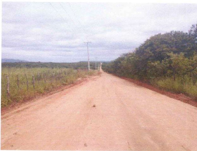
FIGURA 21 – EXECUÇÃO DE ESTRADAS VICINAIS NO MUNICÍPIO DE RIACHO DA CRUZ – RN - TRECHO NA COMUNIDADE BAIXA DO ARROZ;
