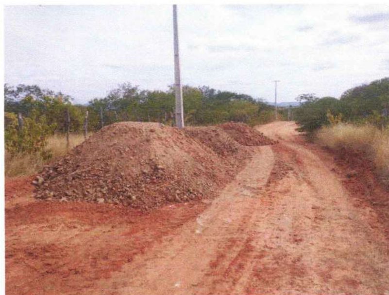
FIGURA 10 – EXECUÇÃO DE SERVIÇO DE TRANSPORTE DE MATERIAL COM CAMINHÕES BASCULANTES – TRECHO NA COMUNIDADE BAIXA DO ARROZ;
