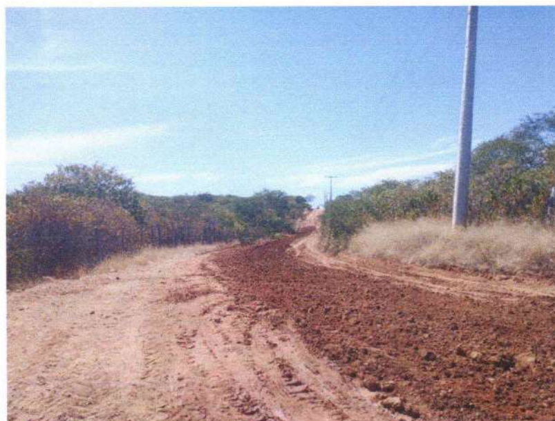
FIGURA 14 – EXECUÇÃO DE SERVIÇOS DE CORTE/HOMOGENEIZAÇÃO DE MATERIAL COM TRATOR E GRADE DE DISCO – TRECHO NA COMUNIDADE BAIXA DO ARROZ;
