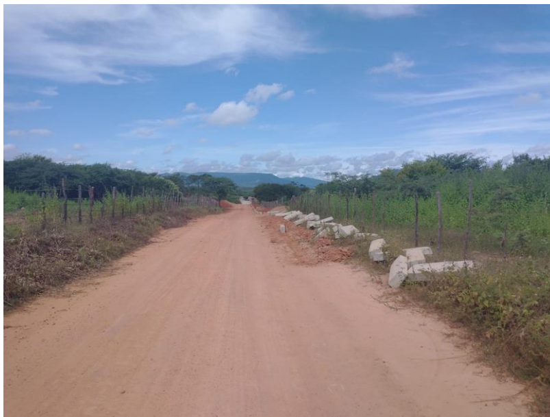
Figura 9 – EXECUÇÃO DOS SERVIÇOS DE REGULARIZAÇÃO, COMPACTAÇÃO DE SOLO E ASSENTAMENTO DE MEIO-FIO EM CONCRETO – COMUNIDADE ARACAJU;
