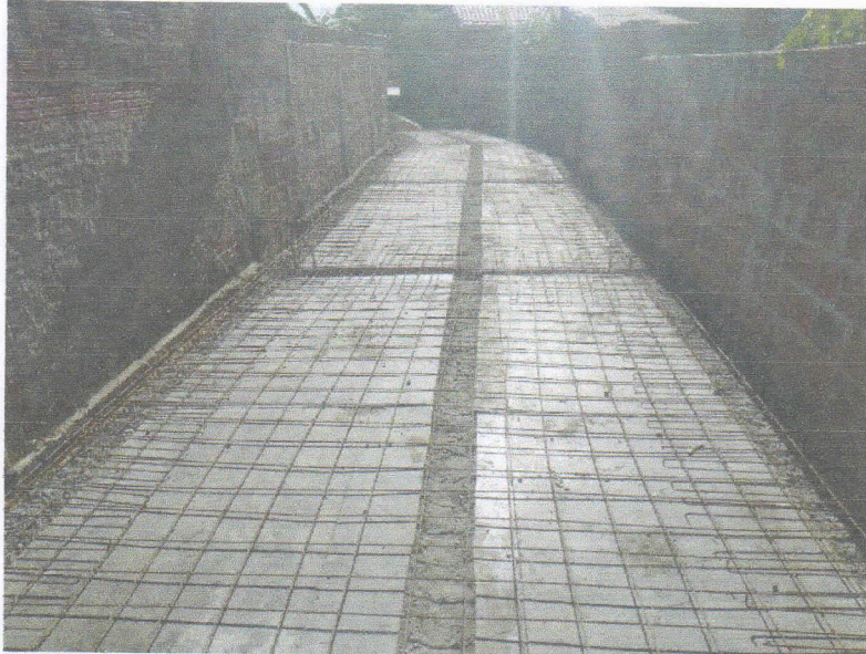
FIGURA 5 – MONTAGEM DE ARMADURA E FORMAS PARA CONCRETAGEM CANAL DE DRENAGEM DO TRECHO ENTRE A RUA PROFESSORA DALILA DA FONSECA ROCHA E RUA 15 DE NOVEMBRO;
