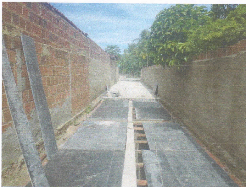
FIGURA 6 - MONTAGEM DE ARMADURA E FORMAS PARA CONCRETAGEM CANAL DE DRENAGEM DO TRECHO ENTRE A RUA PROFESSORA DALILA DA FONSECA ROCHA E RUA 15 DE NOVEMBRO;
