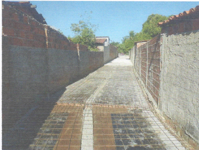
FIGURA 7 – MONTAGEM DE ARMADURA E FORMAS PARA CONCRETAGEM CANAL DE DRENAGEM DO TRECHO ENTRE A RUA PROFESSORA DALILA DA FONSECA ROCHA E RUA 15 DE NOVEMBRO;
