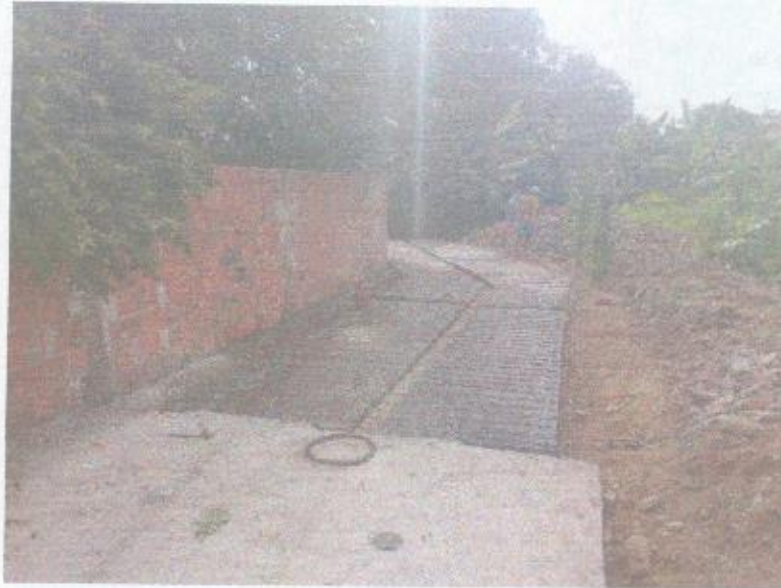
FIGURA 7 – MONTAGEM DE ARMADURA E FORMAS PARA CONCRETAGEM CANAL DE DRENAGEM DO TRECHO ENTRE A RN – 177 E RUA PROFESSORA DALILA DA FONSECA ROCHA;
