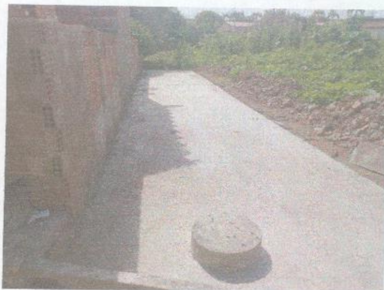
FIGURA 11 – LAJE DO CANAL DE DRENAGEM DO TRECHO ENTRE A RN – 177 E RUA PROFESSORA DALILA DA FONSECA ROCHA;
